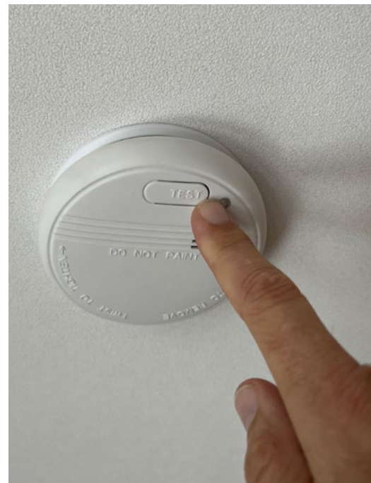
■ Kuva 7: Palovaroittimen testaus.
